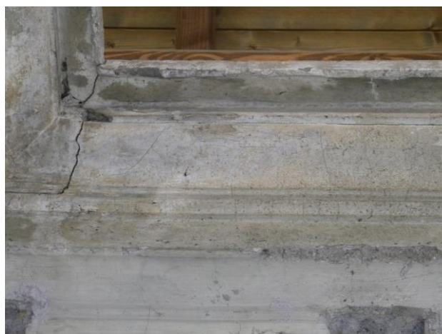
Foto 33 – Facciata nord – cornice di coronamento fessurazioni ed erosione dell'intonaco
