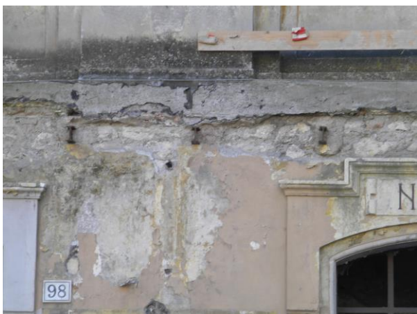
Foto 28 – Facciata nord – mancanza di intonaco
