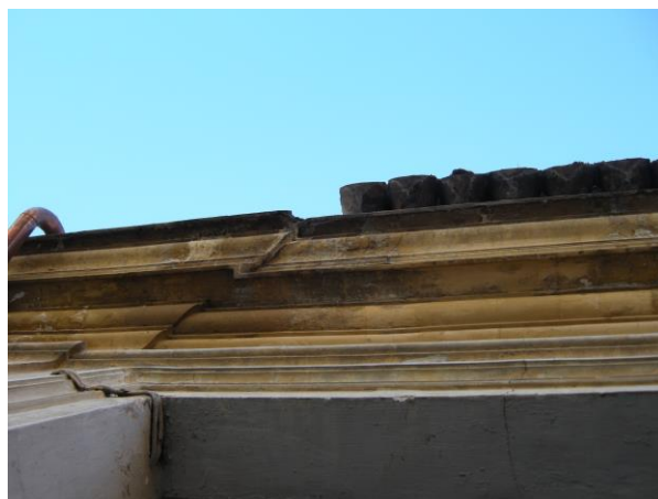
Foto 29 – Facciata nord – particolare cornice macchie di muffa –annerimento diffuso
