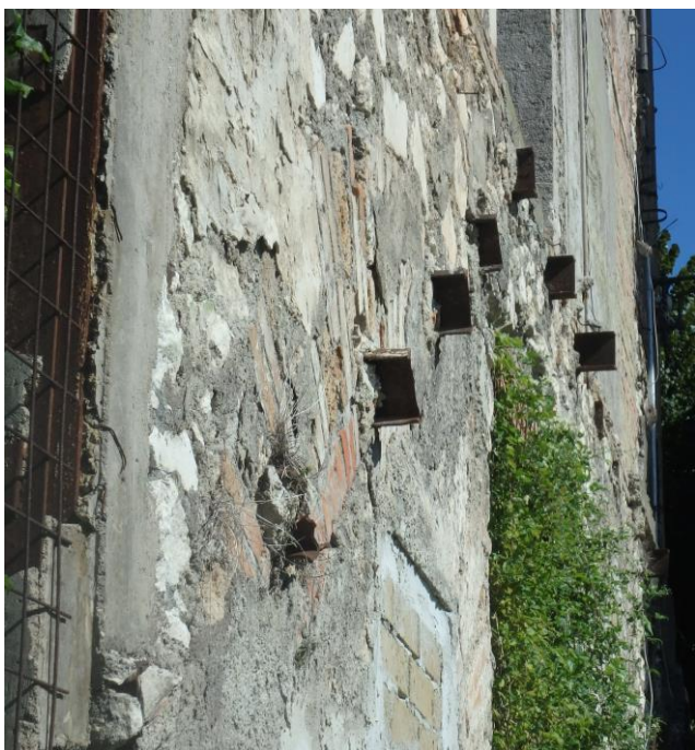
Foto 43 – Facciata sud – rappezzi incongrui – alterazione chimica elementi in ferro
