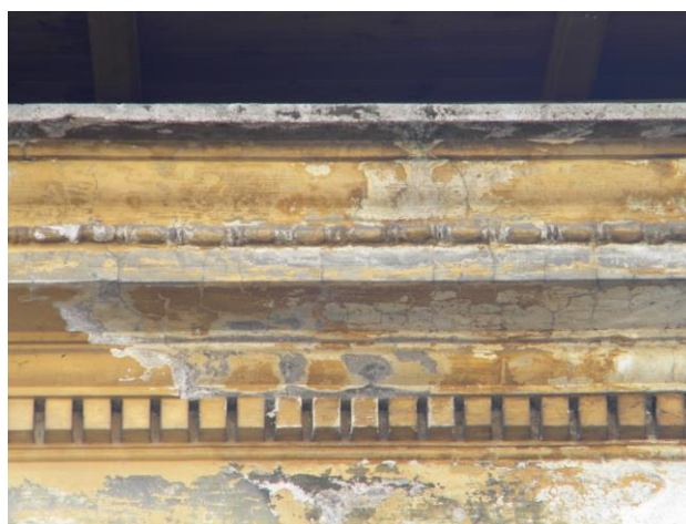
Foto 31 – Facciata nord – particolare cornice degradazione cromatica
