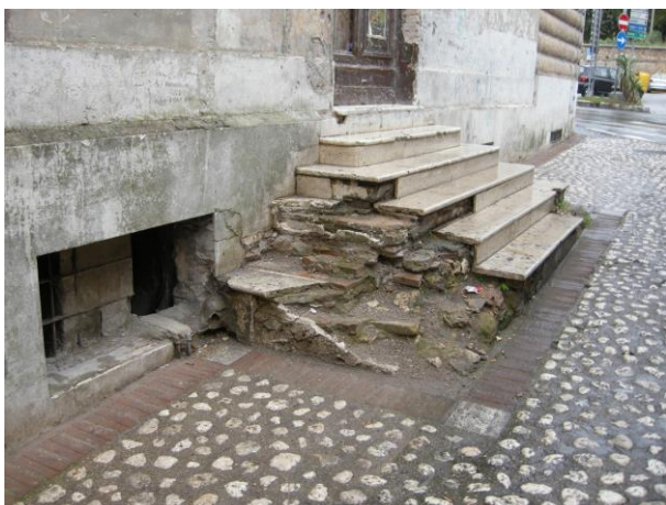
Foto 36 – Facciata est – scalinata in travertino mancanza di materiale
