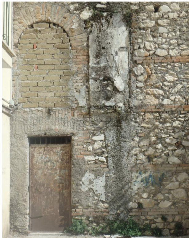
Foto 46 – Facciata ovest – degrado antropico - graffiti distacco intonaco – rappezzo incongruo
