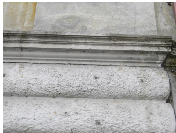
Foto 37 – Facciata est – annerimento ed erosione dell'intonaco
