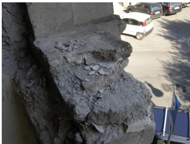
Foto 40 – Facciata nord – mancanza di materiale
