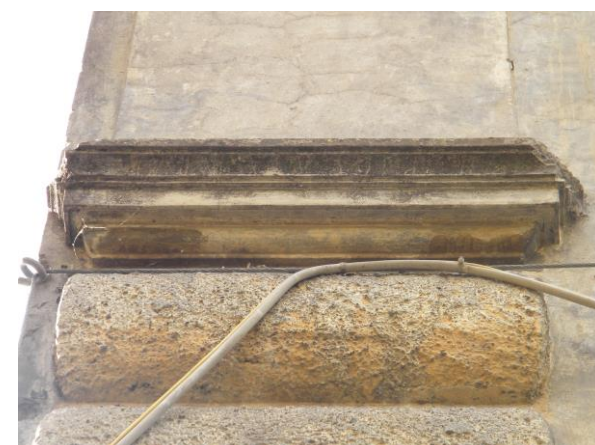
Foto 27 – Facciata nord – particolare decorativo decorativo – erosione e annerimento
