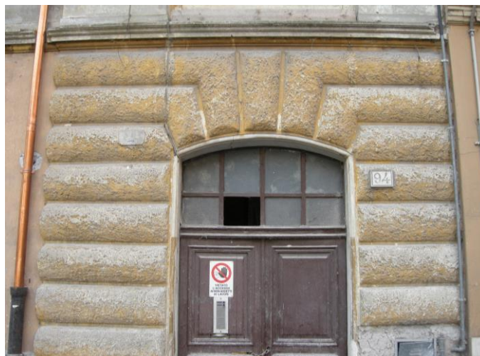
Foto 6 – Prospetto nord – intonaco bugnato di uno degli elementi verticali angolare
