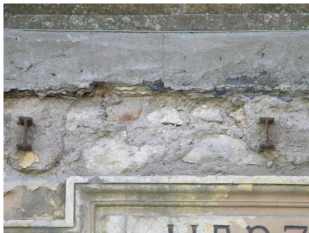
Foto 21 – Facciata nord – perdita di intonaco
