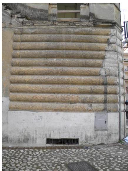
Foto 38 – Facciata est – rappezzo incongruo con materiale cementizio
