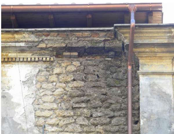
Foto 30 – Facciata nord – perdita di materiale
