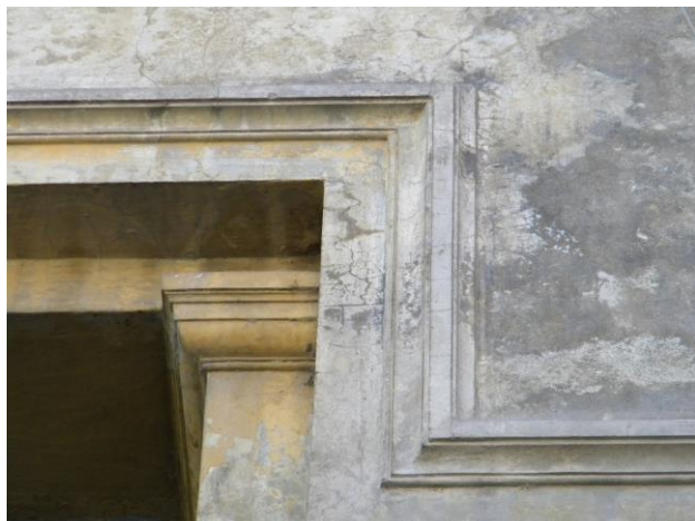
Foto 20 – Facciata nord – sfogliamento dell'intonaco
