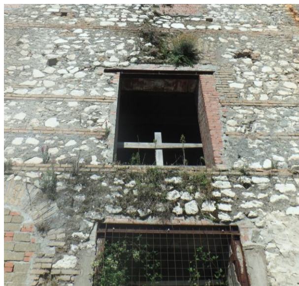
Foto 42 – Facciata sud – vegetazione infestante - infissi mancanti
