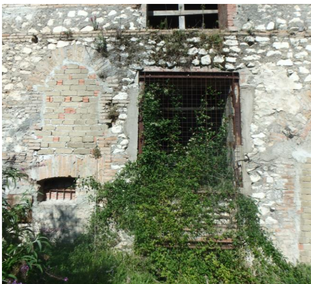
Foto 41 – Facciata sud – vegetazione infestante
