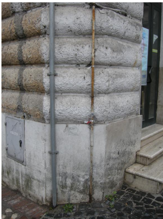
Foto 35 – Facciata nord – particolare apparato decorativo rappezzi incongrui in intonaco cementizio
