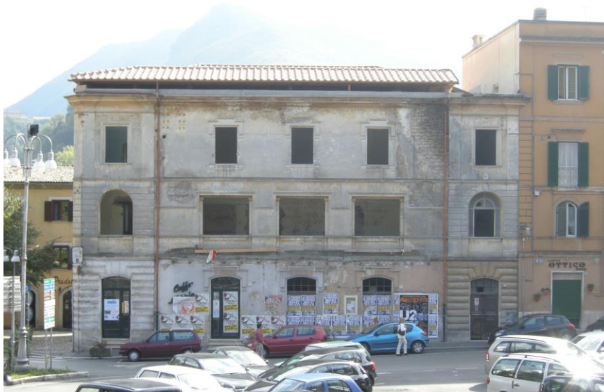
Foto 5 – La facciata nord dopo la demolizione della pensilina in c.a. e di altri elementi incongrui
