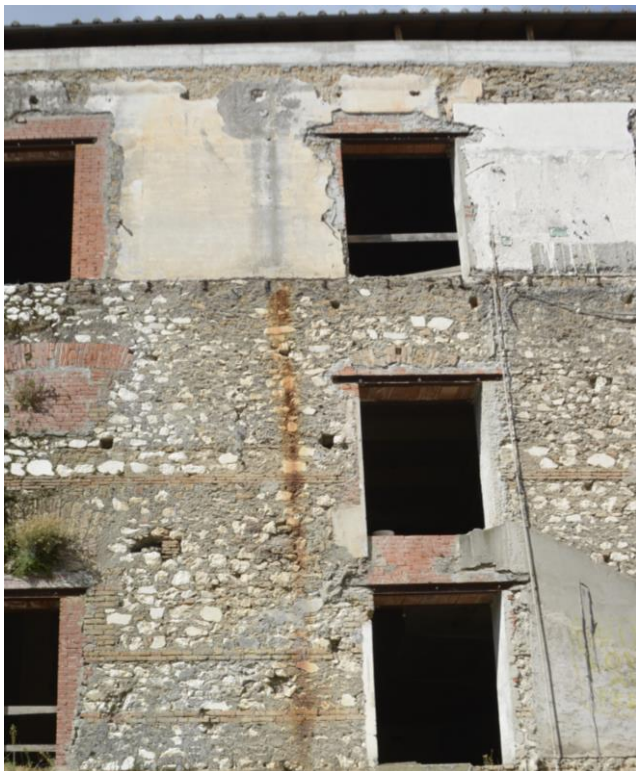
Foto 45 – Facciata sud – colaticcio - degradazione cromatica intonaco – lacuna intonaco
