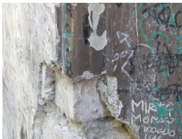
Foto 25 – Facciata nord – degrado antropico
