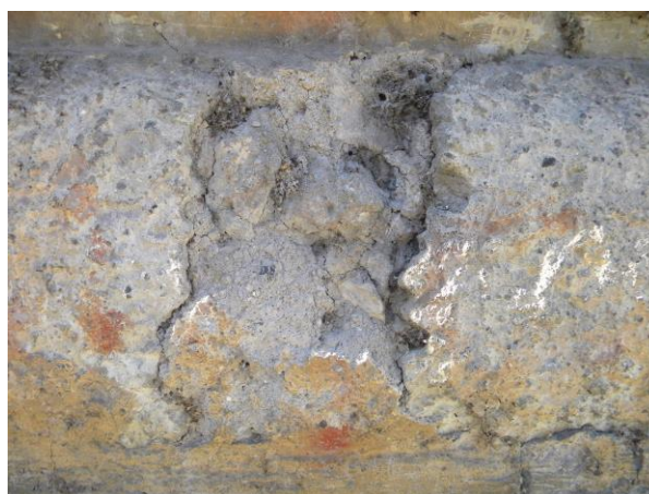
Foto 23 – Facciata nord – fessurazione del materiale
