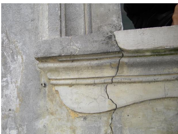
Foto 32 – Facciata nord – particolare cornice finestra fessurazioni
