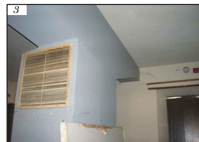
Nuovo impianto di climatizzazione adiacente ai pilastri, particolare del bocchettone di areazione (D)
