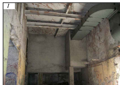
Profili d'acciaio di consolidamento del solaio (B) e canalizzazione dell'impianto di climatizzazione e locale caldaia rialzato (D)
