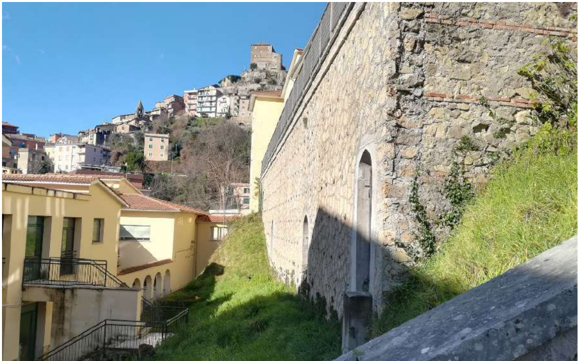
Foto 18 – Muro in pietrame su cui poggia il solaio al livello del piano terra della Scuola Materna
